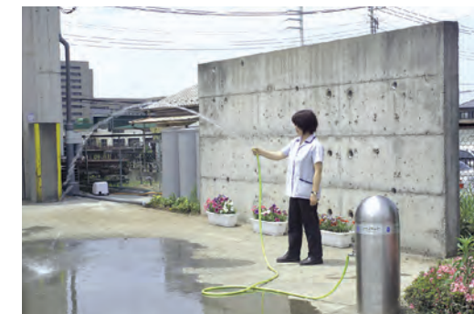
▲ 補助タンク(中央部)の雨水は送水ポンプでレインポストⅠーA型に送られ、散水に利用されている。
