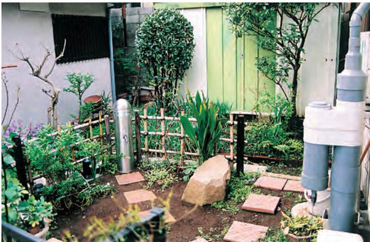
◀屋根に降った雨水は、ぶんりゅうⅡ型（写真右端）を経て、地下に埋設されているタンク（レインデポⅡ型2連式、容量1m）に貯水される。この雨水はポンプで汲み上げられて、写真中央部のレインポストI-B型で散水等に使われるほか、屋内2ヶ所のトイレで流し水として使用されている。
