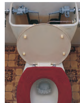
▲ 普通タイプのトイレ 雨水タンクからの水を100%供給。左側の水道水の補給はストップしてある。
