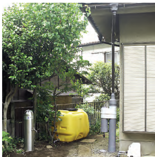
▲ ぶんりゅうⅡ型を経て集水された雨水は、いちど補助タンクに貯えられ、加圧ポンプによってレインポストに送られ、散水等に使われている。
