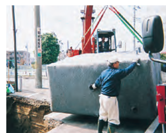
▲ 地下に埋設したCSTの貯水槽
