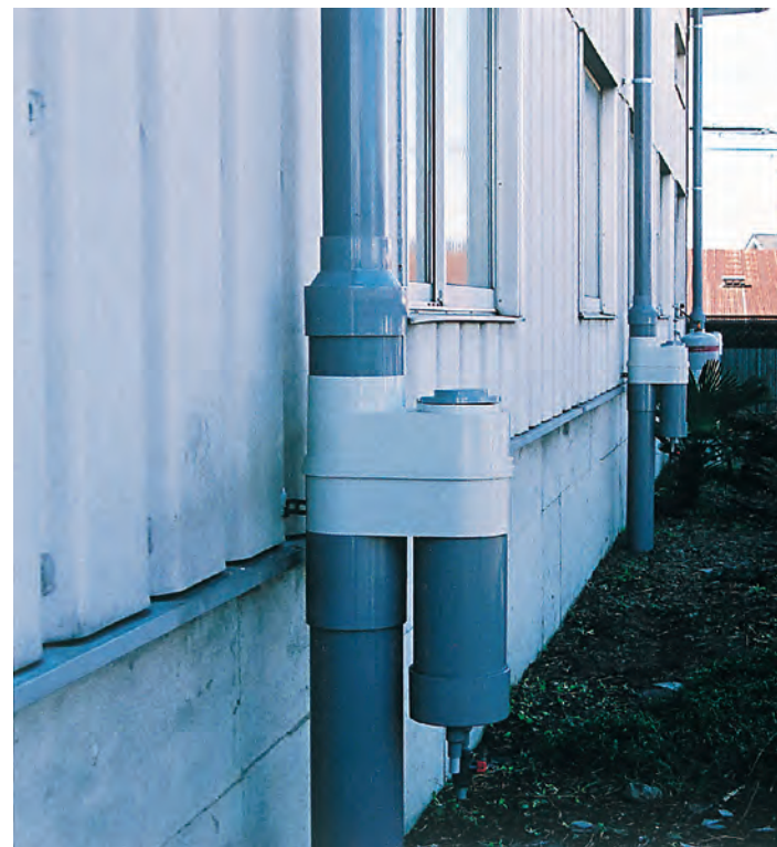
▲ 工場の屋根から集水している例。各縦樋に取り付けられた「ぶんりゅうⅡ型」でゴミや汚染物質が除去された雨は、地下貯水槽に導かれ、そこを水源として、散水、洗車、トイレの流し水、夏場の屋根散水など、多目的に利用されている。
