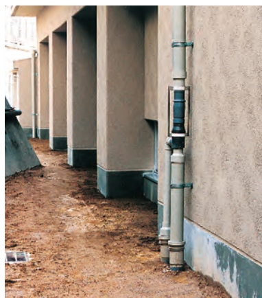
▲ 兵庫県神戸市鷹羽小学校で。ぶんりゅうⅠ型で浄化した雨水を地下貯水槽へ導き、トイレの流し水として使用している。
