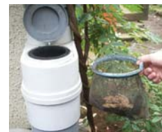
開口部から取り出したストレーナー
