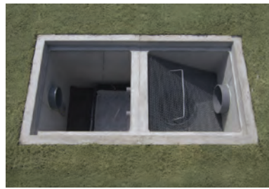
除塵管理柵設置例
