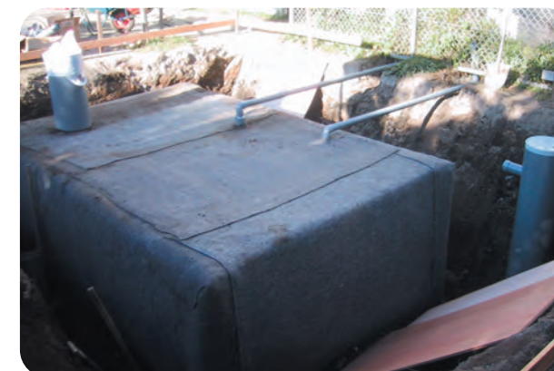
▲ 設置場所：東京都内の保育園 利用目的：手押しポンプによる水利用と人工流水（せせらぎ）への水供給 貯水量：10トン
