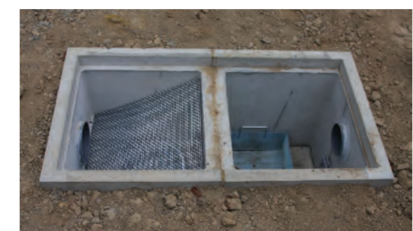
設置された除塵管理枡の内部
