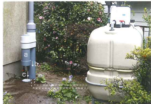
▲ ぶんりゅうⅡ型とレインデポーⅠ型の組合せ aは初期雨水溜り。きれいな雨水がbへ流下し、地下の管を通して右側のタンクへ。cからはごく少量の雨水を排出。
