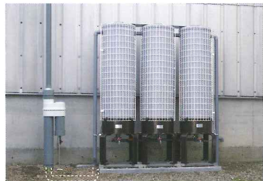
▲ ぶんりゅうⅡ型とガーデンオアシスⅡ型の組合せ 左のぶんりゅうⅡ型で塵埃等が除かれ、きれいな雨水が右のタンクに送り込まれる。
