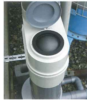
◀写真② フロートが上昇した状態
